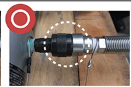
接続部分の取付の良い例 ねじ部分に隙間なし
