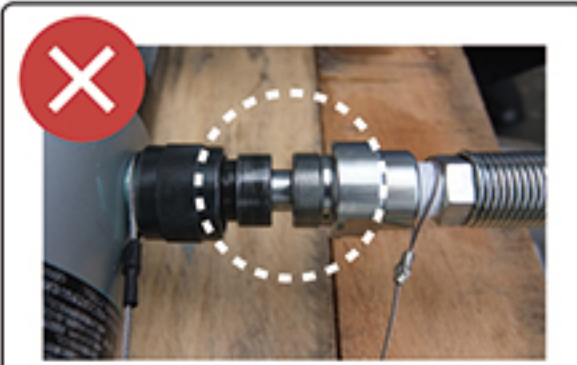
カプラー差込みの悪い例 ねじ部分に隙間あり
